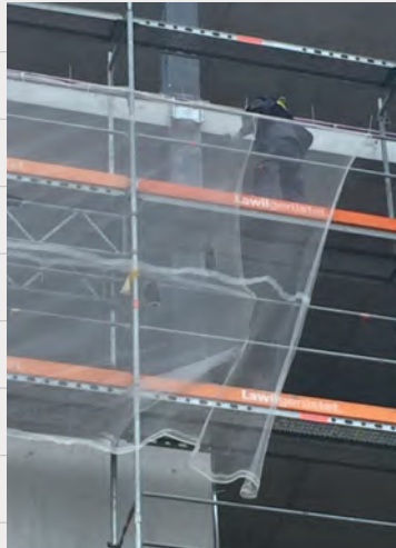
安全帯を取付けていない作業員-1
