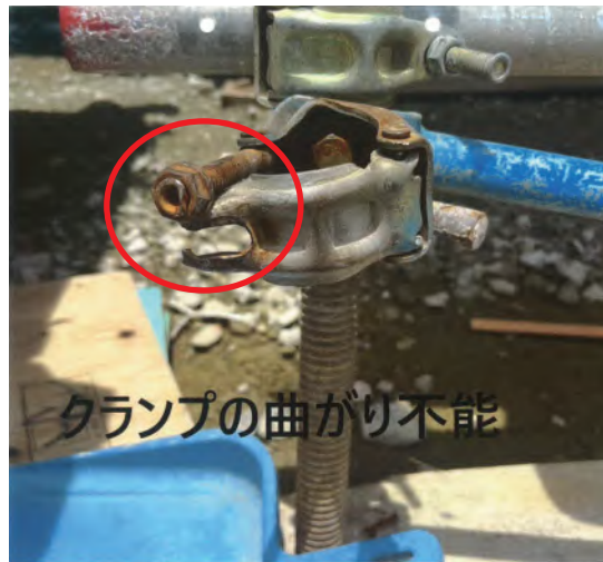
写真2-36 階段手すりに使用するクランプの曲がり及びさび（廃棄）
