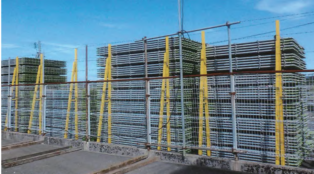
写真4-31 落下防止用の背あての使用状況
