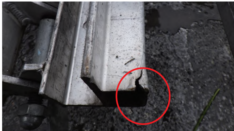
写真2-29 システム式防護柵（朝顔）のコーナー用 センター端部フレームの亀裂（廃棄）
