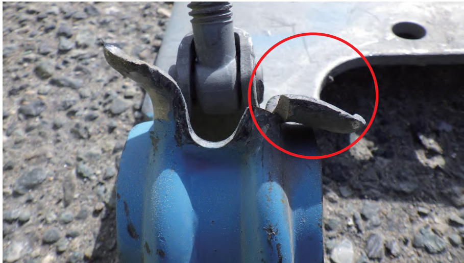
写真2-31 システム式防護柵（朝顔）の主材受金具取り付けクランプの亀裂（廃棄）
