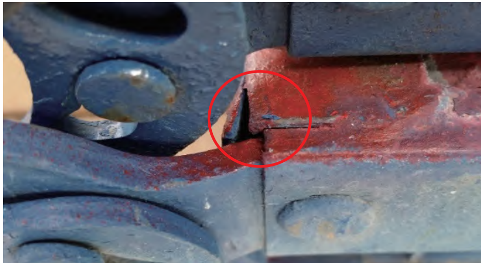
写真2-12 床付き布わくののり材の亀裂（廃棄）
