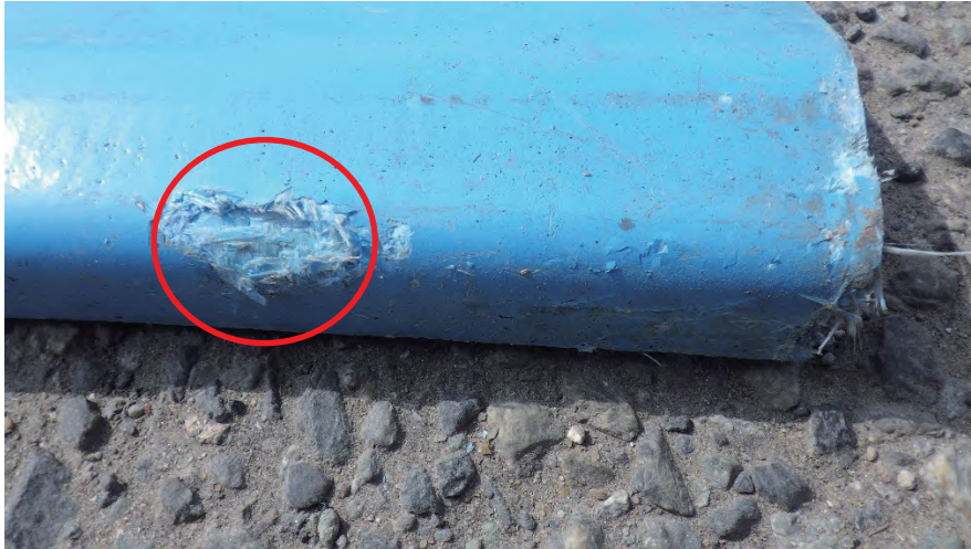
写真2-30 システム式防護柵（朝顔）のバンノー板（FRP）の損傷（廃棄）
