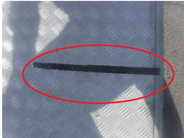
写真2-21 システム式つりだな足場の床材の亀裂（廃棄）
