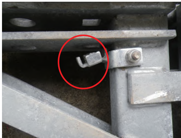
写真2-26 システム式つりだな足場の ゲージナットの変形(取替)
