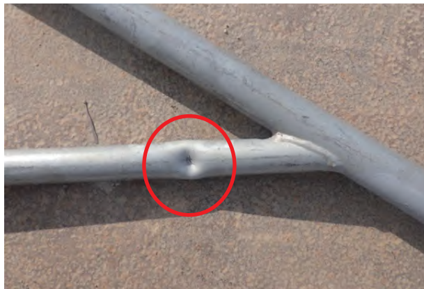
写真2-15 緊結部付ブラケットの斜材の へこみ (廃棄)
