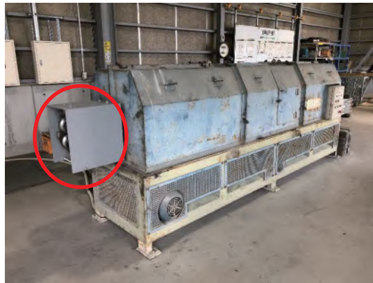
写真4-34 単管ケレン矯正機の単管出口部安全カバーの取付後 改善後
