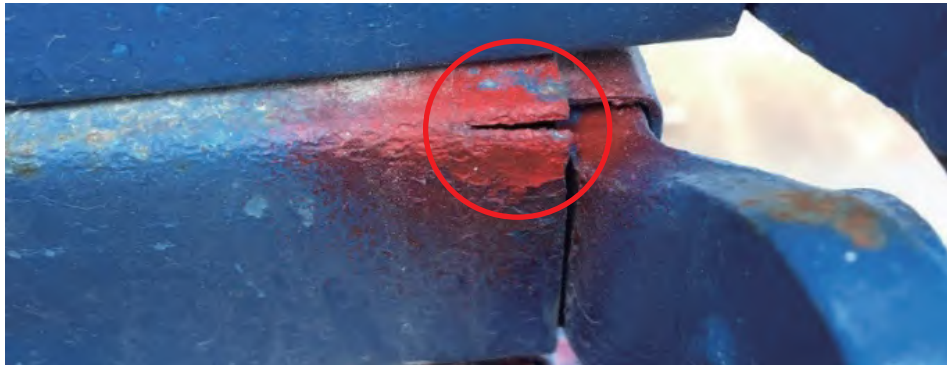
写真2-11 床付き布わくののり材の亀裂（廃棄）
