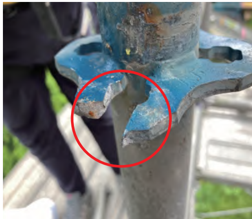
写真2-3 緊結部付支柱のフランジの亀裂（廃棄）
